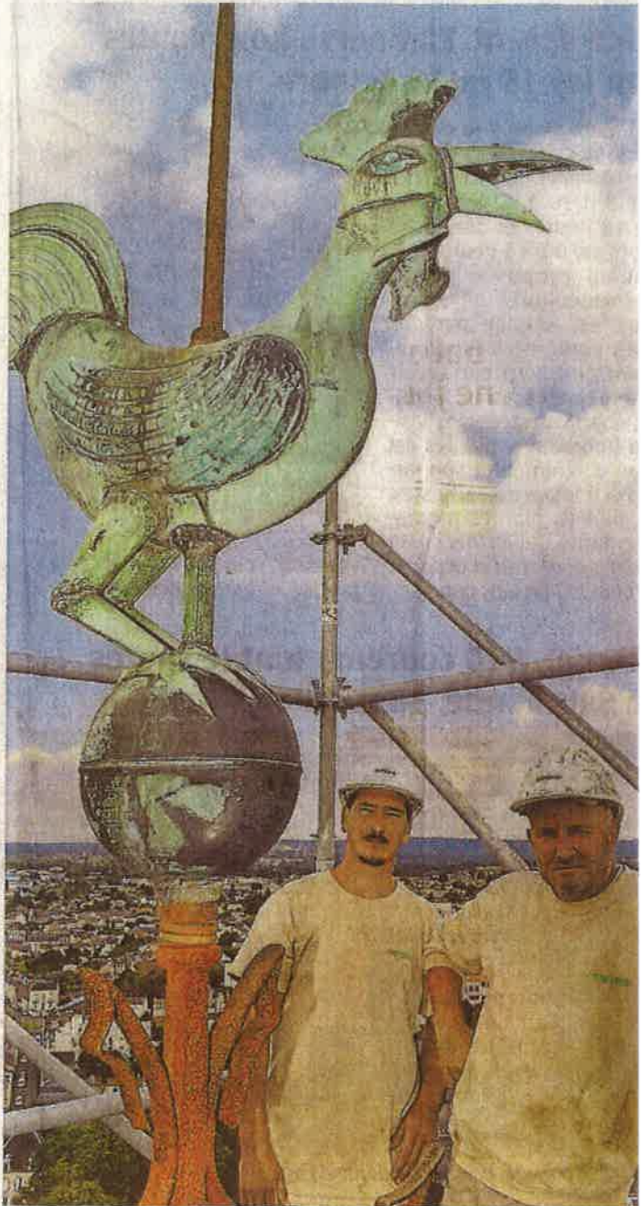
À Parthenay, mardi. Basile Quéret, tailleur de pierre, et Christian Charrier, sont bien partis pour trois ans de travaux à l'église Saint-Laurent.
